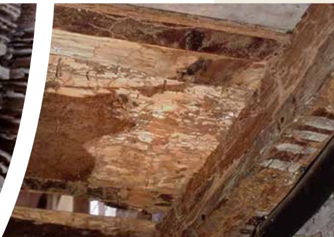
Attaques sur un solivage de plancher
