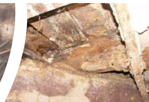
Humidité et condensation sur un solivage de cave
